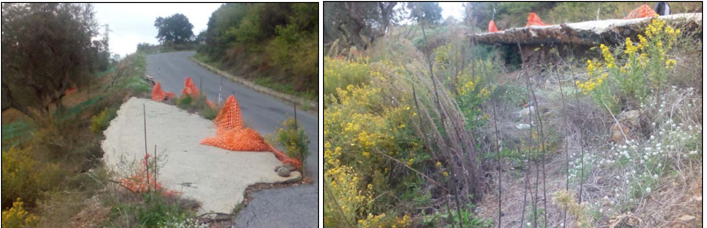
Foto n 3 e 4 – Tratto di strada Timpone/Torrecchia interessato dal movimento gravitativo.
