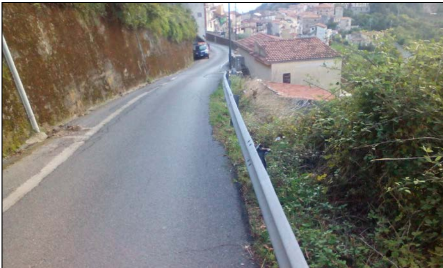
Foto n 8 – Tratto di strada comunale (lato nord) interessato dal movimento gravitativo.
