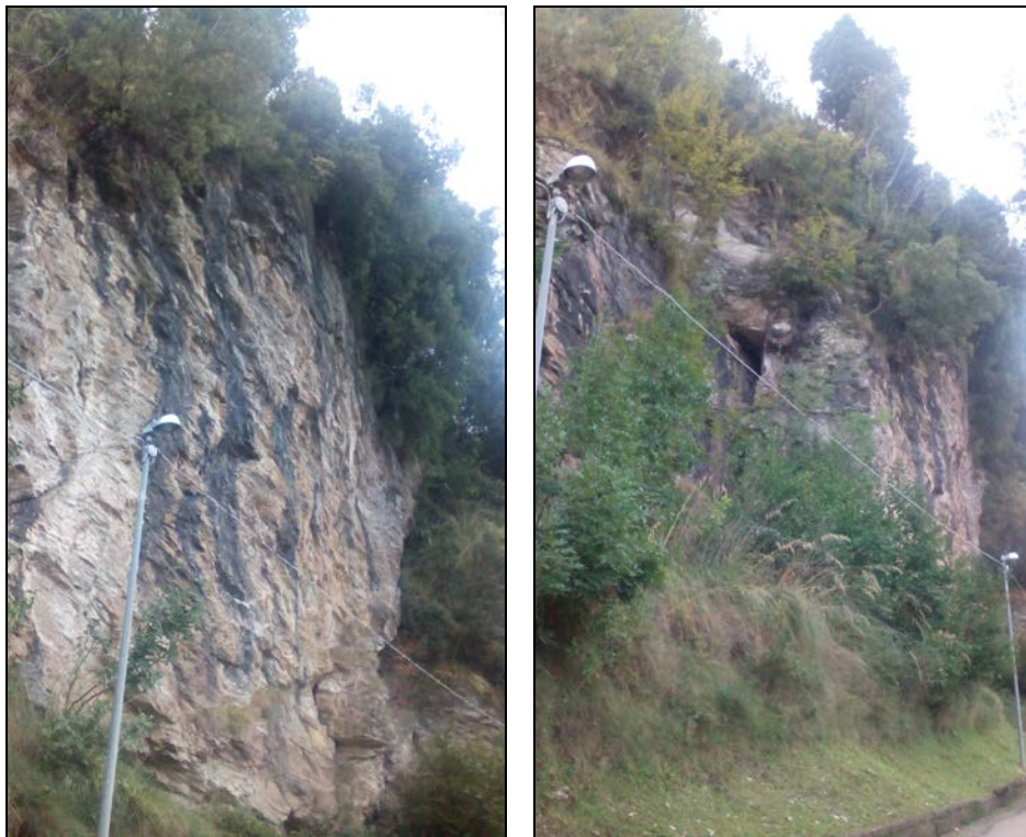
Foto n°1 e 2 – Costone roccioso antistante strada comunale ingresso cimitero comunale.
