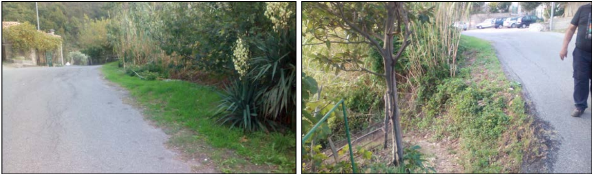
Foto n° 13 e 14 – Tratto della strada comunale località del centro storico di Bonifati lato sud.
